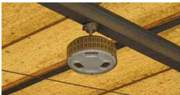
LED電灯(テント倉庫)
